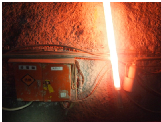
図 1: アームに設置された分電盤と消火器
