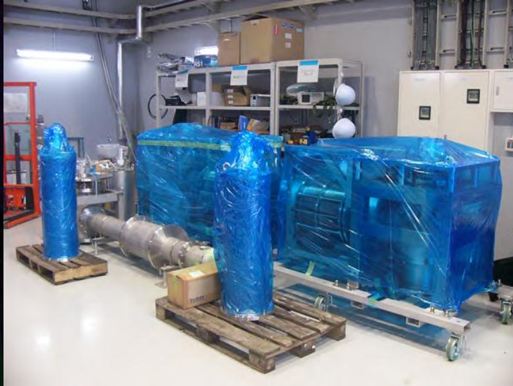
Cryo-cooler units at ICRR (Kashiwa)
